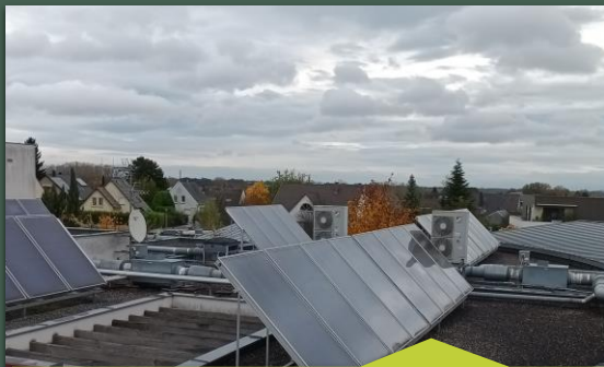
Production d'eau chaude sanitaire en énergie solaire
